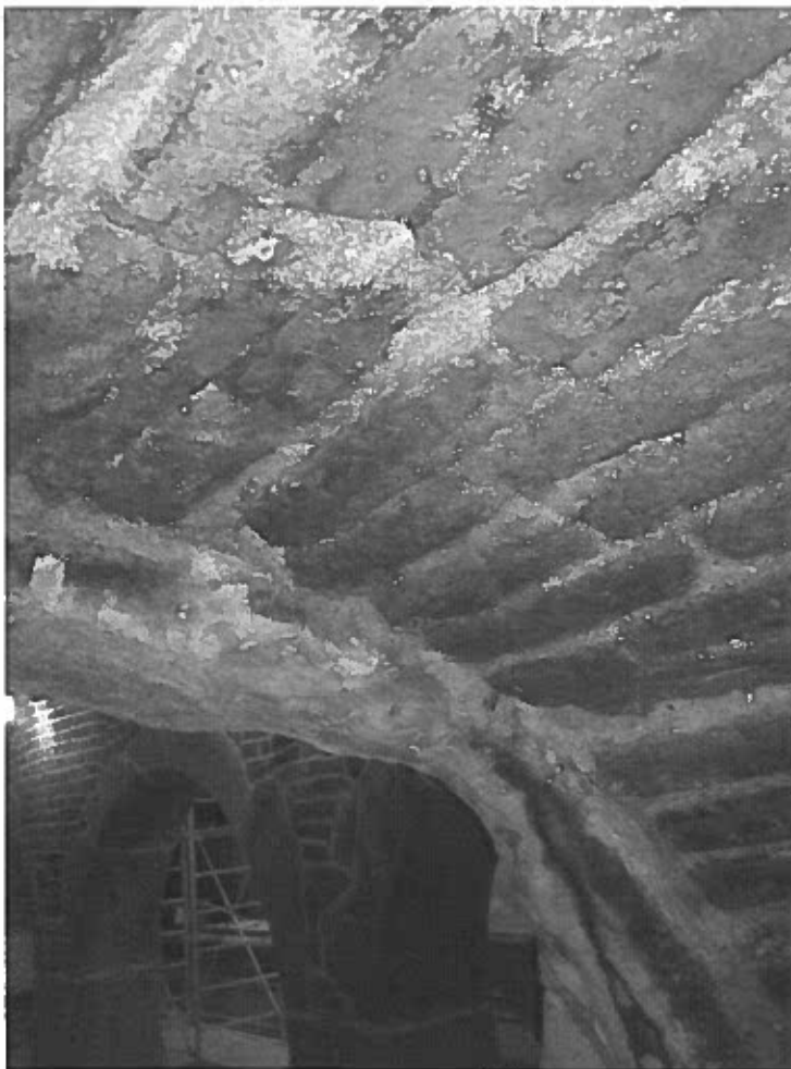
FOTO ZONA ACCES SALA EXPUNERE – umezeala generata de infiltratii duce la degradarea zidariei din bolta
