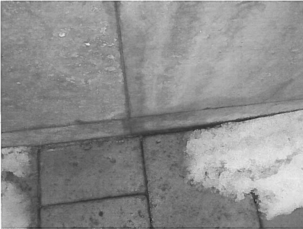
Idem, detaliu – se observa degradarea hidroizolatiei
