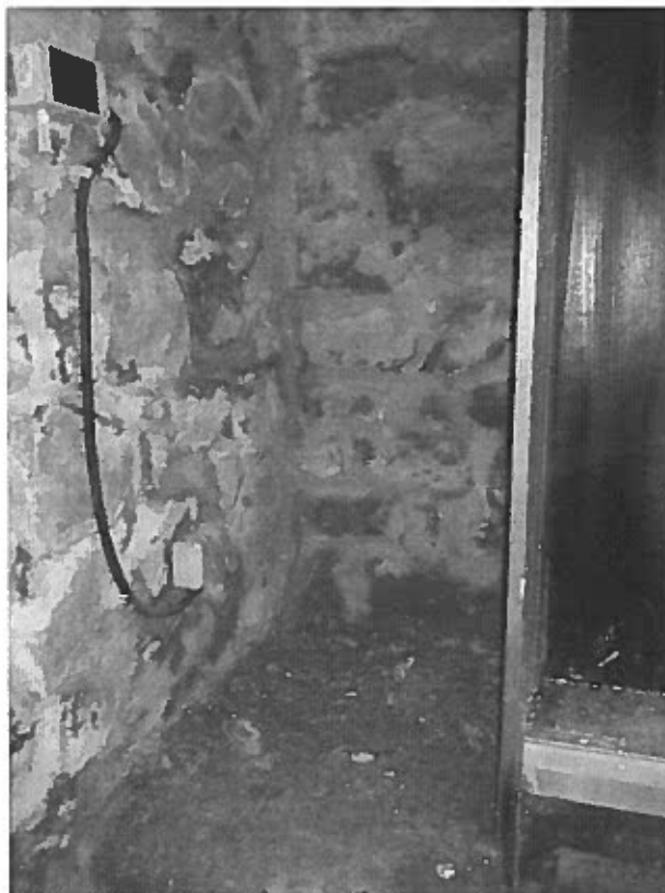
FOTO ZONA SALA EXPUNERE – umezeala generata de infiltratii si defectiuni ale sistemului de ventilatii a degradat zona expozitionala
