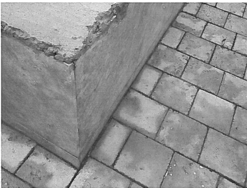
Detaliu atic – se observa hidroizolarea deficitara.
