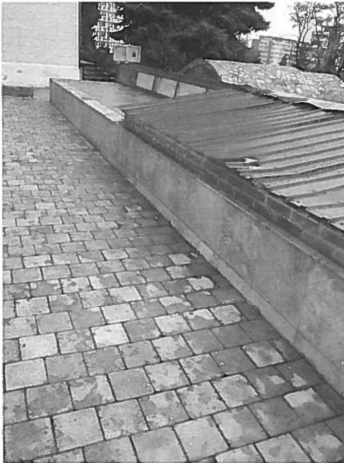
Terasa care acopera beciul, mai precis sala de expunere, are panta catre atic cauzand acumulari de apa la ros. Acetea se infiltreaza in peretele de piatra si in bolti.
