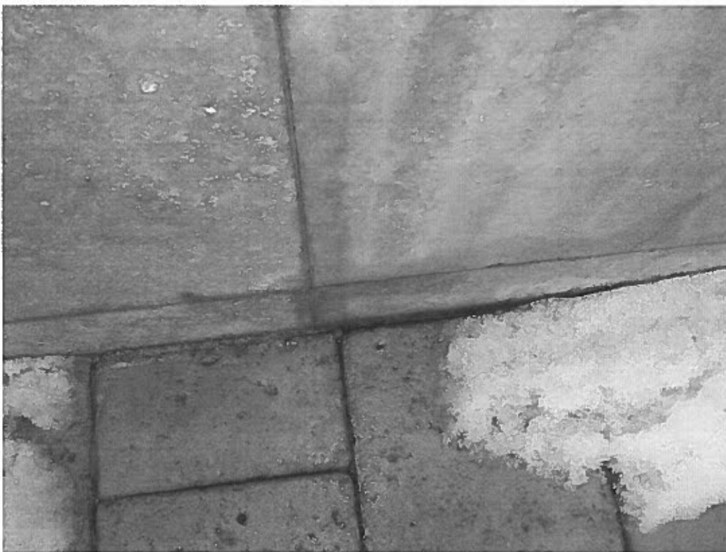
Idem, detaliu – se observa degradarea hidroizolatiei
