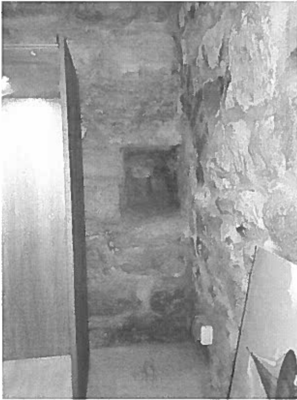
FOTO ZONA SALA EXPUNERE – umezeala generata de infiltratii si defectiuni ale sistemului de ventilatii a degradat zona expozitionala
