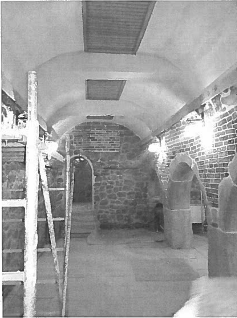
FOTO ZONA SALA EXPUNERE – infiltratii la bolta
