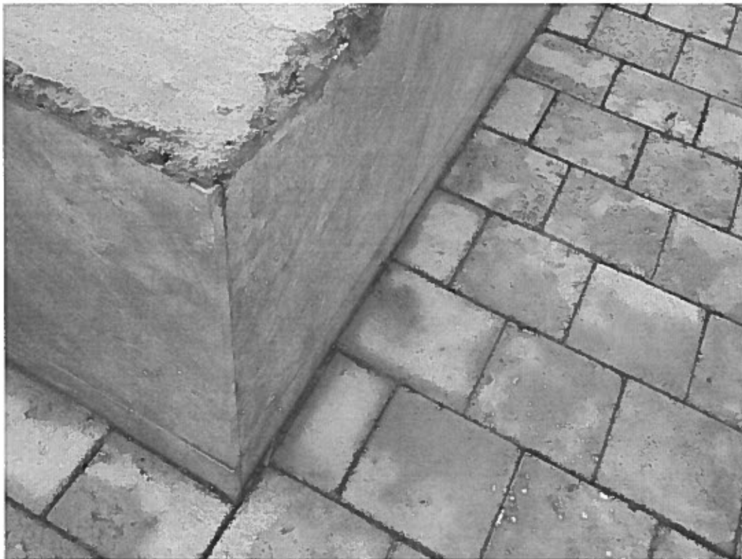
Detaliu atic – se observa hidroizolarea deficitara.
